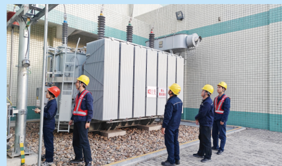
在专项工作组操作下，云霄110千伏陈岱变电站2号主变五次冲击完成
